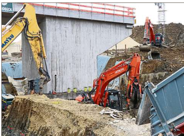
Am Ende der Bachstraße wird eine neue Bahnbrücke neben der eigentlichen Strecke gebaut und am heutigen Dienstag in die richtige Position verschoben. Foto: Kauffmann
